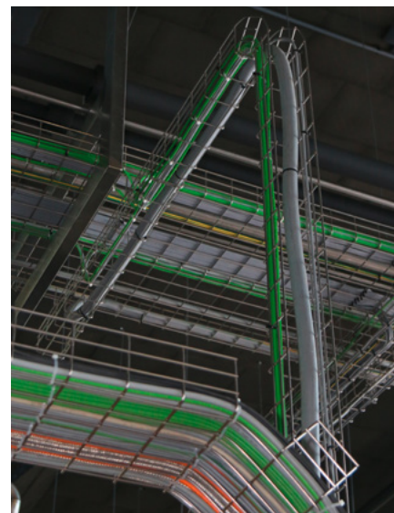
Gitter-Kanal-Installation in unterschiedlichen Querschnitten in der Abfüllanlage (Bild: Lutz)
